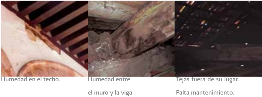
Figura 11. Ejemplos de causas de daño en vigas de madera.
