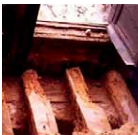
Figura 22. Cabezas de vigas que deben consolidarse (Rodríguez, 1998).
