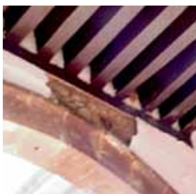
Figura 13. Efecto de la humedad en vigas de pasillos. Foto del autor.
