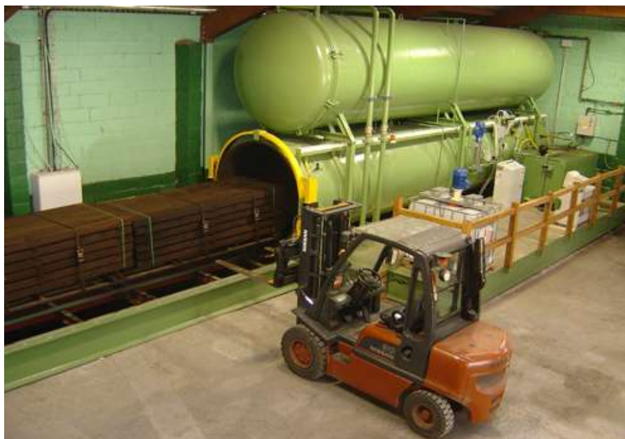
Figura 9: Planta de preservación por sistemas de vacío-presión
